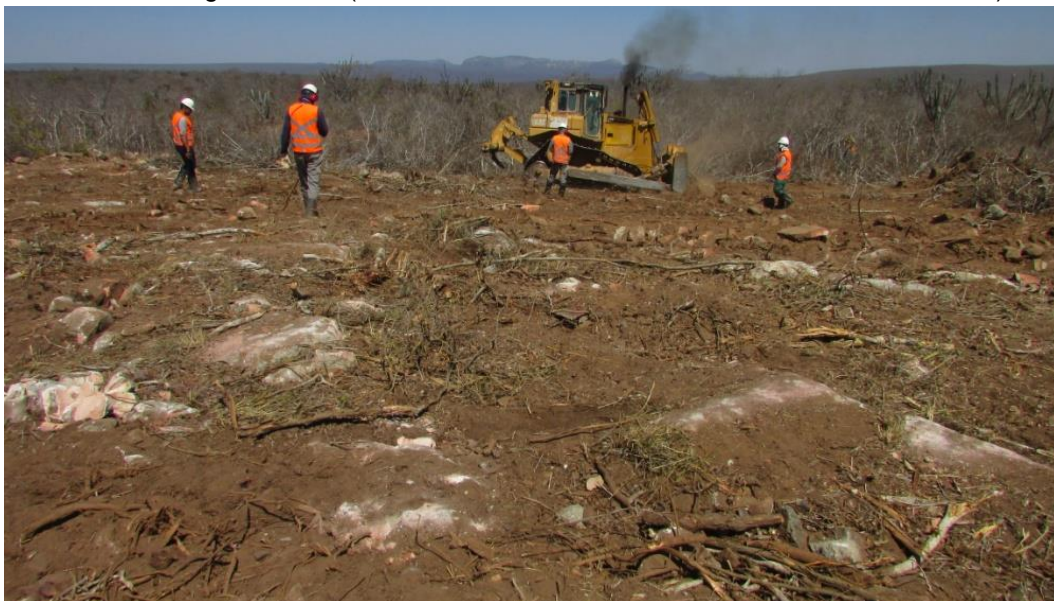
Figura 16 - Monitoramento arqueológico da atividade de supressão vegetal mecanizada na área do aerogerador 01. (COORDS UTM SIRGAS 2000 24 L 0231348/8837055).
