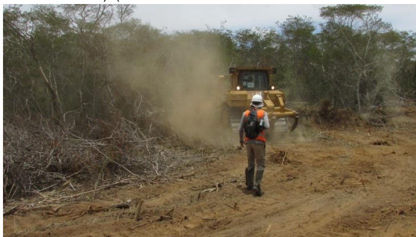
Figura 5 - Acompanhamento do maquinário realizando a retirada do material lenhoso (supressão mecânica). (COORDS UTM SIRGAS 2000 24 L 0227543/8836884).
