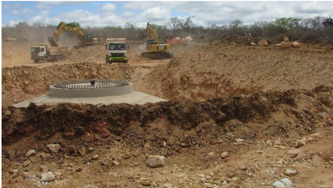
Figura 43 - Acompanhamento arqueológico das atividades de terraplanagem da praça do aerogerador 08. (COORDS UTM SIRGAS 2000 24 L 0230192/8835229).
