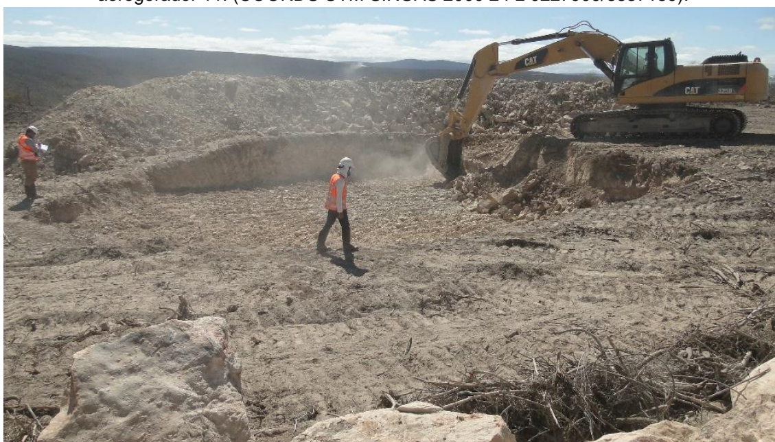
Figura 38 - Acompanhamento arqueológico das atividades de escavação da base do aerogerador 11. (COORDS UTM SIRGAS 2000 24 L 0227909/8837189).
