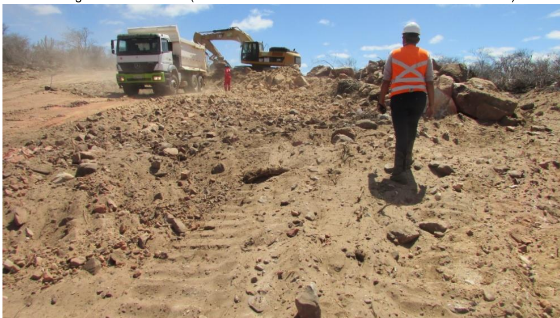
Figura 28 - Acompanhamento arqueológico da atividade terraplanagem da ligação dos aerogeradores 05 e 06. (COORDS UTM SIRGAS 2000 24 L 0230597/8835903).
