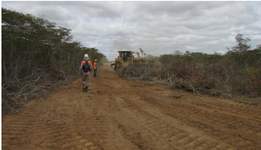
Figura 4 - Acompanhamento do maquinário realizando a retirada do material lenhoso (supressão mecânica). (COORDS UTM SIRGAS 2000 24 L 0226909/8837169).
