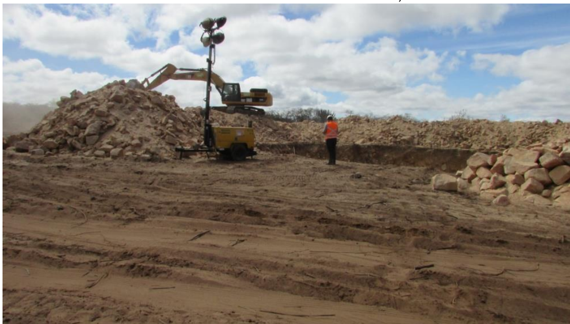
Figura 26 - Registro da finalização da escavação da base do aerogerador 08. (COORDS UTM SIRGAS 2000 24 L 0230176/8835253).
