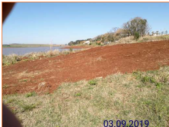
Figura 8.7 - Movimentação de terra em área de APP no Condomínio Martinazzo, Campinas do Sul-RS.
