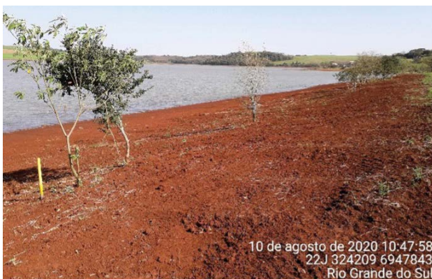
Figura 8.2 – Movimentação de terra realizada irregularmente em APP, Trindade do Sul - RS.
