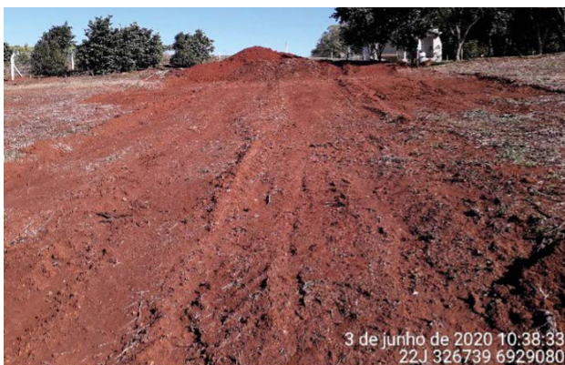
Figura 8.4 - Movimentação de terra em APP, Condomínio Parque da Amizade, Ronda Alta -RS.
