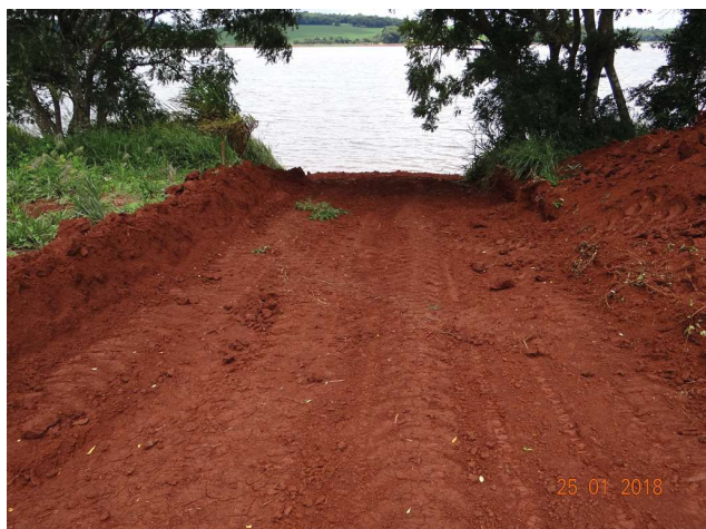
Figura 8.2 – Abertura de acesso irregular em área de APP no Condomínio Martinazzo, Campinas do Sul/RS.
