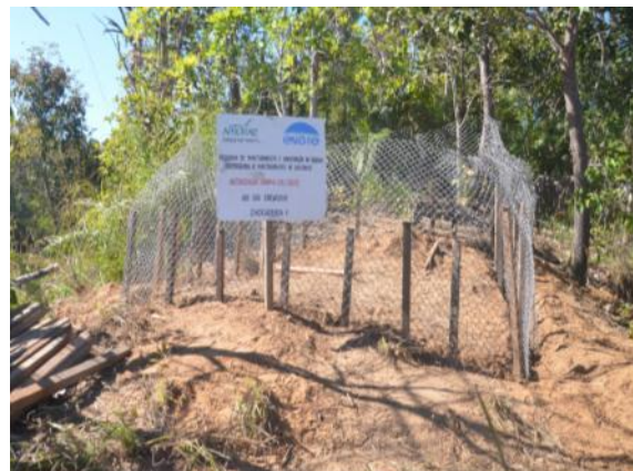
Proteção de tela galvanizada instalada em área de ninhos
