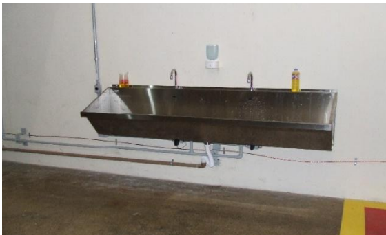
Lavatório na área da oficina p/ lavagem das mãos sujas de óleo e ou graxa.
