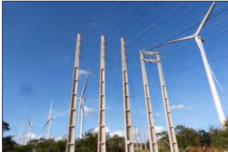
Fotografia 89 – Redes de Média Tensão no Complexo Eólico, que podem causar algum impacto direto ou indireto para a avifauna.
