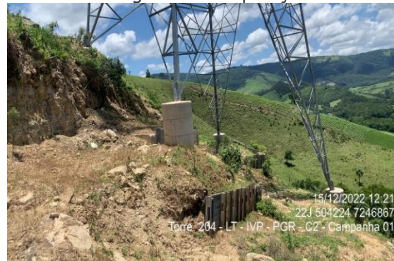
Figura 1.8. IVP-PGR C2 T 204 em estado regular de recuperação com paliçadas soltas e baixo desenvolvimento da vegetação.
