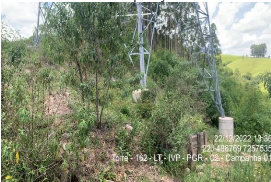
Figura 1.6. IVP-PGR C2 T 162 em bom estado de recuperação.
