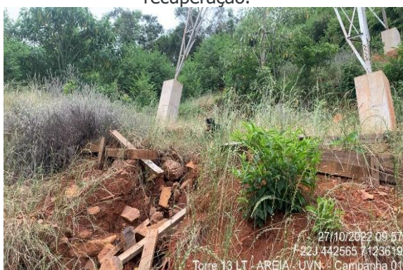
Figura 1.6. ARE-UVN T 13 em estado regular de recuperação com paliçadas danificadas.
