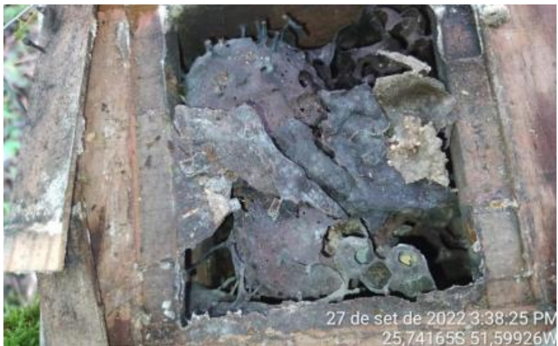
Figura 1.34. Caixa tomada por formigas.
