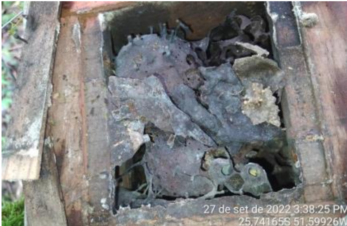
Figura 1.31. Caixa tomada por formigas.
