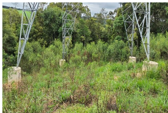
Figura 1.5. IRN-PGR T 64 em estado regular de recuperação com paliçadas danificadas.
